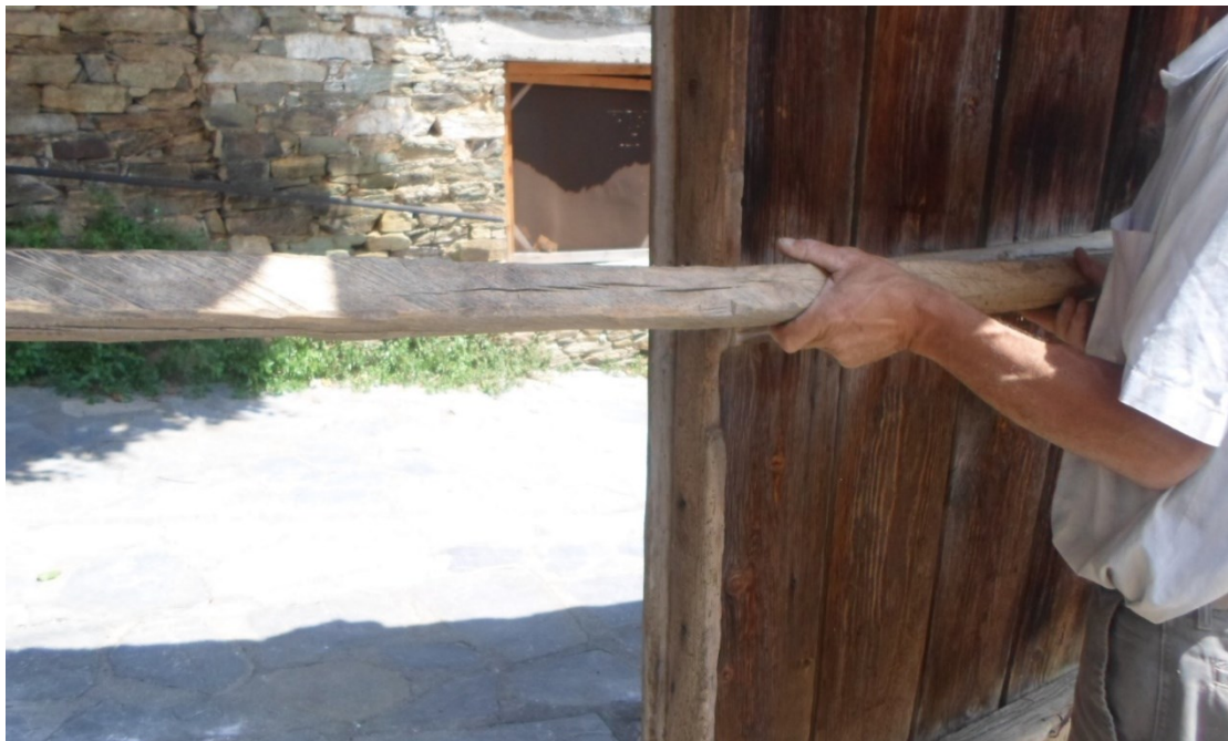
Φ43. Νοικοκυρόσπιτο (αρχοντικού) Βασκαλή: Η αυλόπορτα με την ειδικά πελεκητή επιμήκη ξυλοδοκό, ασφάλισης εντός των αμφίπλευρων πεσσών, με ελαφρά τοξωειδή και μορφή και στρέψη, για να αποτρέπει το να σύρεται από την έξω πλευρά.
